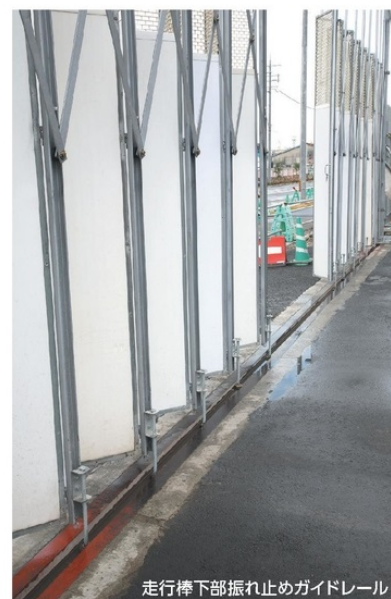
走行棒下部振れ止めガイドレール
